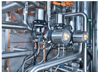
Robinetterie et tuyauterie aseptiques.
